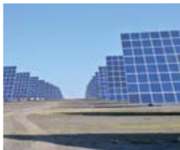
ポルトガルのアンバーセントラル社の太陽光発電所
