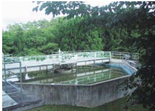
排水処理設備
