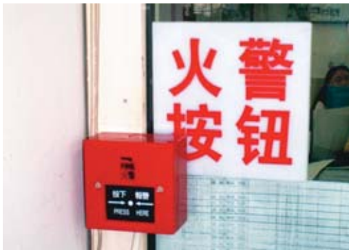
工場内の警報装置を確認
