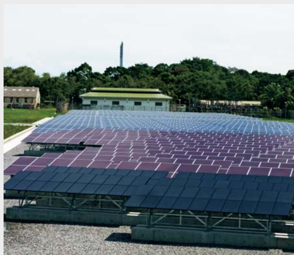
東南アジア最大級の太陽光発電設備（ブルネイ）
