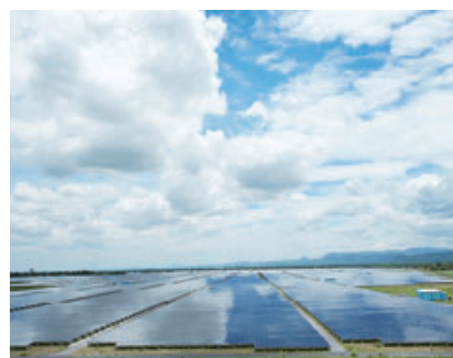
世界最大級である約8.4万kWの太陽光発電所を、タイのロブプリ県で2013年5月より稼働しました。本プロジェクトに対し、三菱商事は約33%出資しています。
