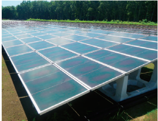
当社が国内で初めて建設・運営するメガソーラー案件の熊本メガソーラー太陽光発電所。
