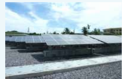
東南アジア最大級の太陽光発電設備（ブルネイ）
