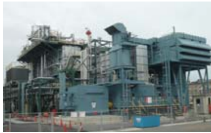
地球環境に配慮した天然ガス焚き最新鋭ガスタービン発電設備。(MCJエネルギーサービス(当社100%子会社)オンサイト発電設備)。
