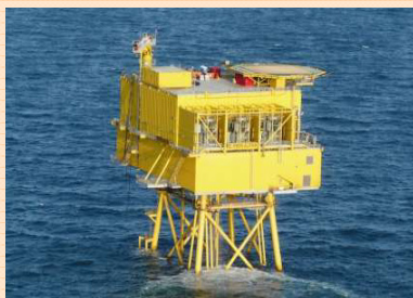
英国海底送電事業の洋上変電所
