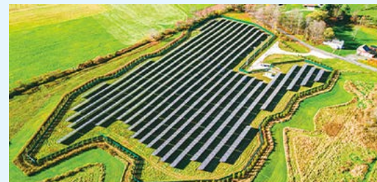
Nexamp社の分散型太陽光発電設備
