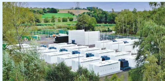
ベルギー エノー州に構える蓄電設備
