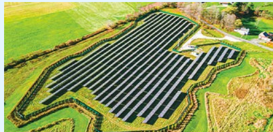
Nexamp 社の分散型太陽光発電設備
