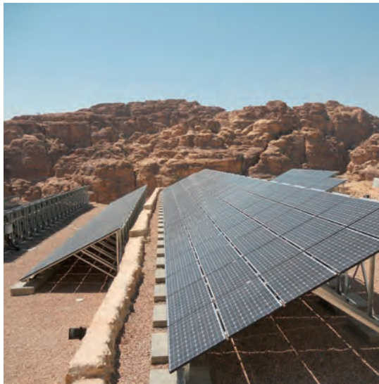
完成した太陽光発電設備
